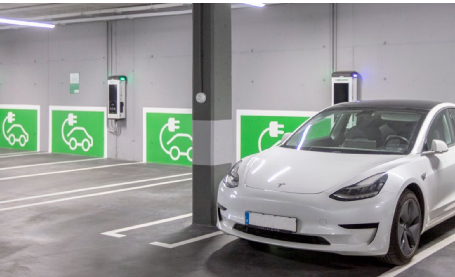
Puntos de recarga para vehículos eléctricos no supermercado de Cañadas del Teide en Paracuellos del Jarama, Madrid.
